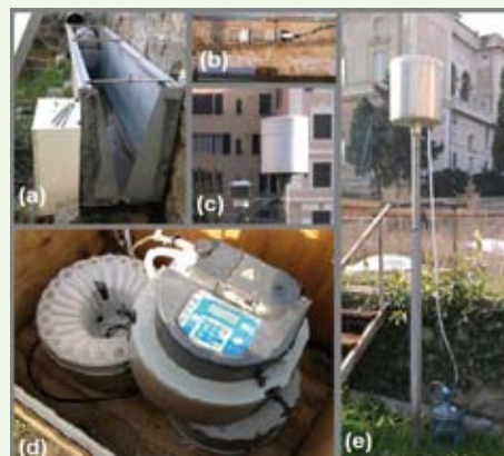
Sistema di monitoraggio delle prestazioni idrologiche: dispositivo per la misura del deflusso (a) con particolare della sonda piezoresistiva (b); stazione meteorologica (c); autocampionatore per il prelievo dei campioni di deflusso (d); dispositivo per il campionamento della deposizione atmosferica (e).
