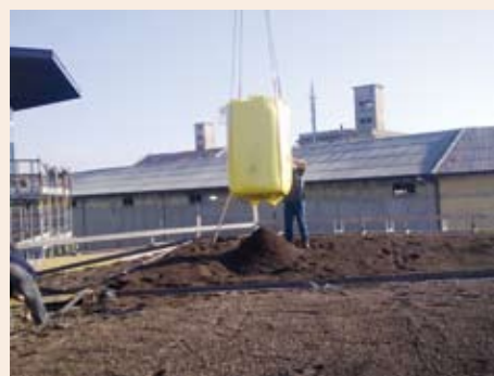
Stesura del substrato per verde pensile, le diverse sezioni della copertura sono separate da una fascia di cor-ten
