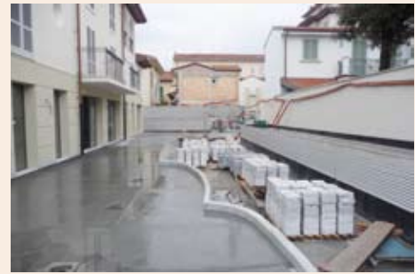
La realizzazione dei cordoli di contenimento e preparazione della struttura del giardino
